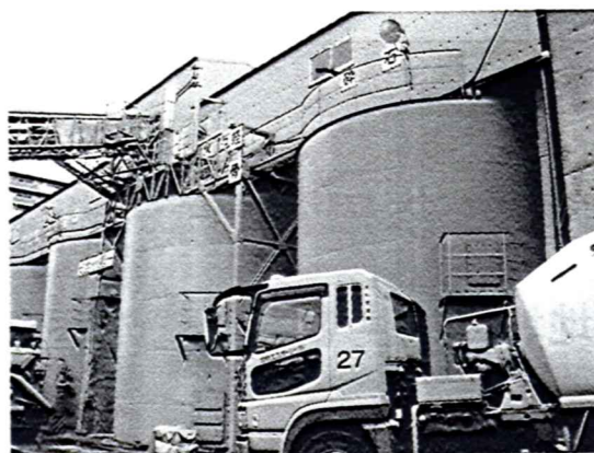
写真-2 鋼製の骨材サイロ
